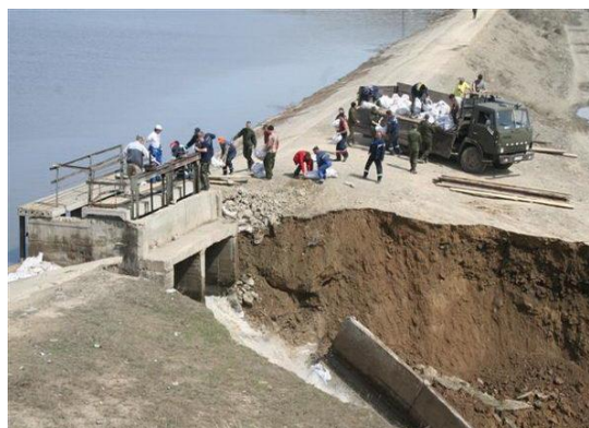
Рисунок 6 – Прорыв плотины Кокпектинского водохранилища
