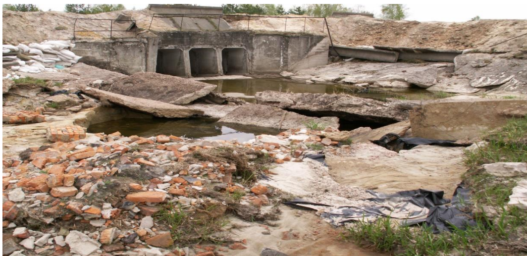
Рисунок 1 – Авария на гидроузле Млынокского водохранилища Гомельской области
